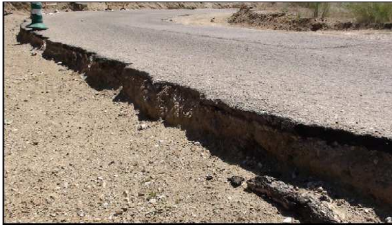
Foto 6_Desnivel entre el firme de la carretera y el firme de la vía pecuaria
