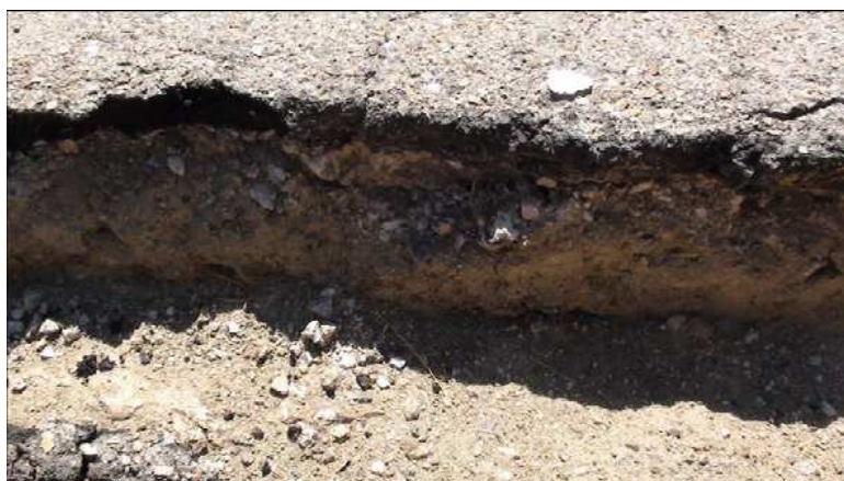
Foto 7_Detalle de desnivel entre firme asfaltado y el terreno natural de la vía pecuaria
