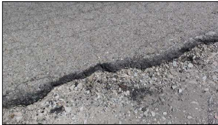
Foto 3_Estado del firme en los márgenes de la carretera
