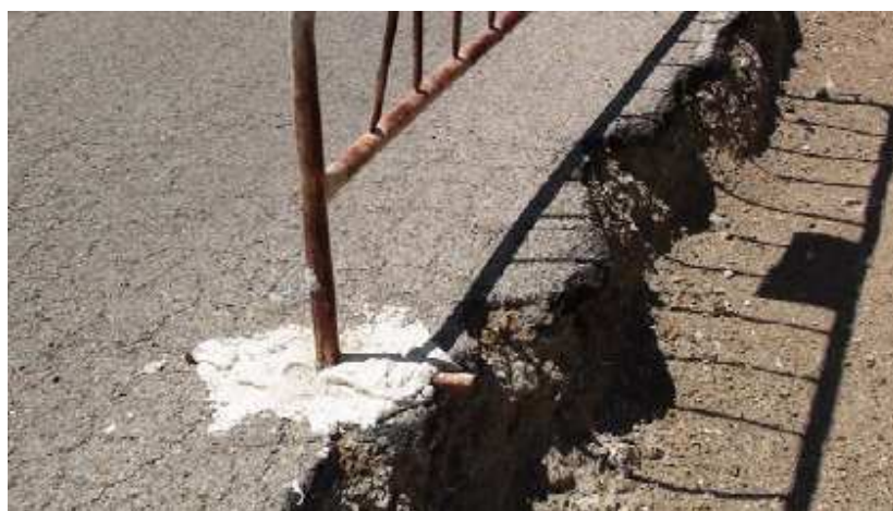
Foto 10_Detalle de la cimentación de la valla de seguridad en el firme de la vía
