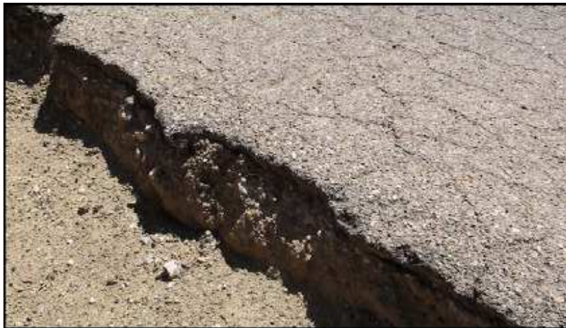
Foto 9_Detalle de desnivel entre firme asfaltado y el terreno natural de la vía pecuaria
