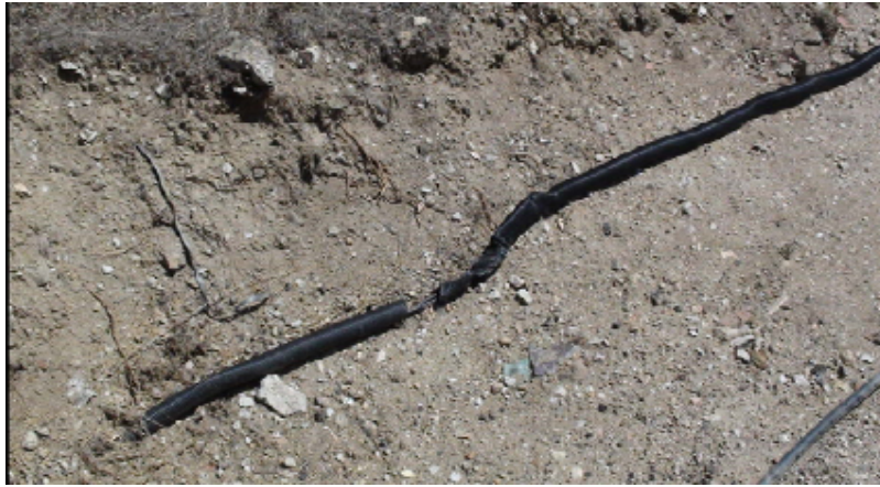
Foto 11_ Cableado de instalación eléctrica
