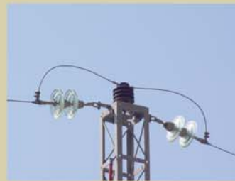
Puente superior: una de las configuraciones peligrosas para las aves
