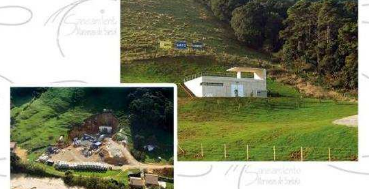
RESTAURACIÓN PAISAJÍSTICA. ZONA DE CÁMARA DE CARGA Y POZO DE HINCA DURANTE LA EJECUCIÓN DE LA OBRA Y UNA VEZ TERMINADA ÉSTA
