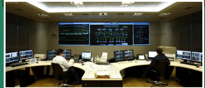
ACTUALIZACIÓN TECNOLÓGICA DE LA HIDROELÉCTRICA
