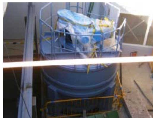
Ciclón instalado en la Central de RNRU
