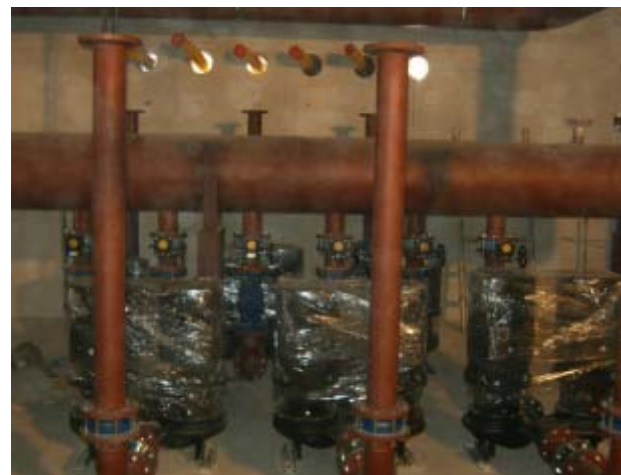
Grupos de presión para el agua caliente y tuberías de salida de ésta hacia las viviendas
