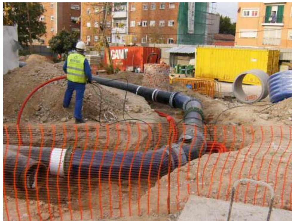
Tubería de la red de RNRU
