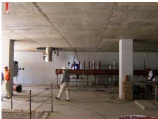
Unión de las calderas con las chimeneas para la extracción de gases de combustión
