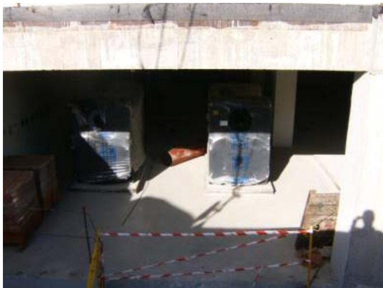
Dos grupos térmicos (calderas de condensación) situados sobre las bancadas instaladas en la sala de calderas de la central de calor
