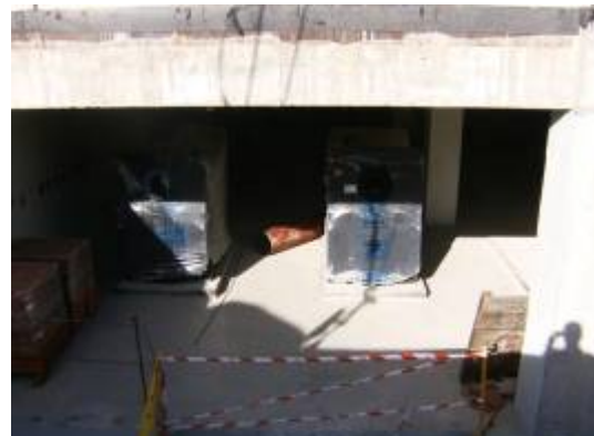
Figura 8.87. Dos grupos térmicos (calderas de condensación) situados sobre las bancadas instaladas en la sala de calderas de la central de calor
