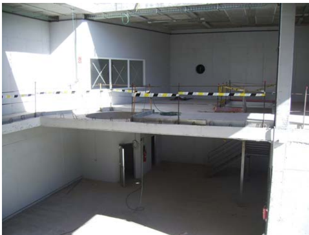
Figura 8.19: acceso Central RNRU y sala de control
