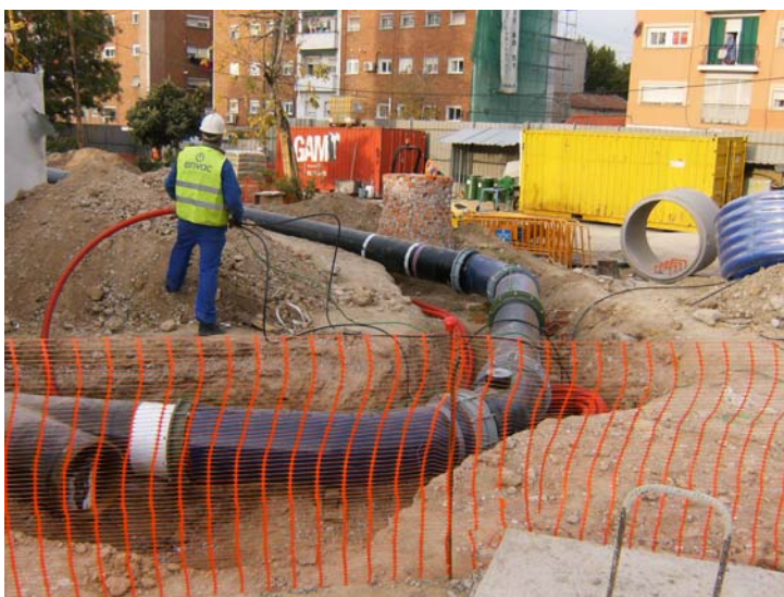
Figura 8.16: tubería de la red de RNRU
