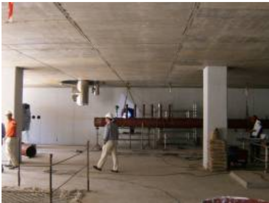
Figura 8.7. Unión de las calderas con las chimeneas para la extracción de gases de combustión
