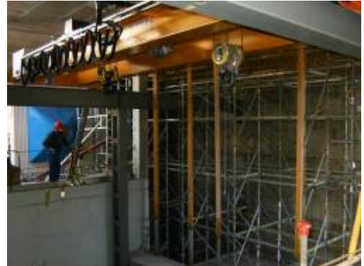
Figura 8.18: puente grúa para movimiento de los contenedores (20.000kgs.)
