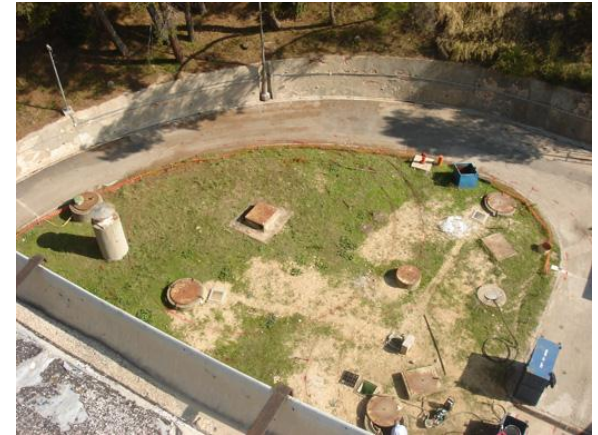
Zona de los depósitos enterrados
