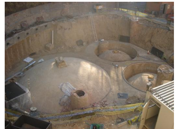
Zona de los depósitos enterrados
