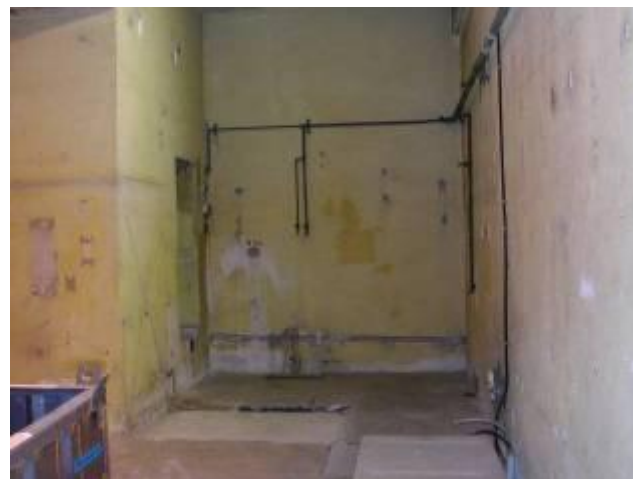
Sala de máquinas (después)
