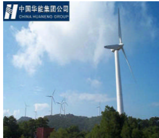
Parque eólico Huaneng (China)
